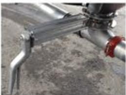
Extensiones de las manillas de las válvulas
