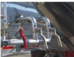
Extensiones de las manillas de las válvulas
